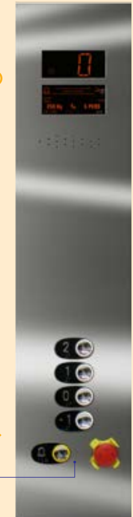
BOTÕES E PAINEL DE COMANDO DA CABINA
